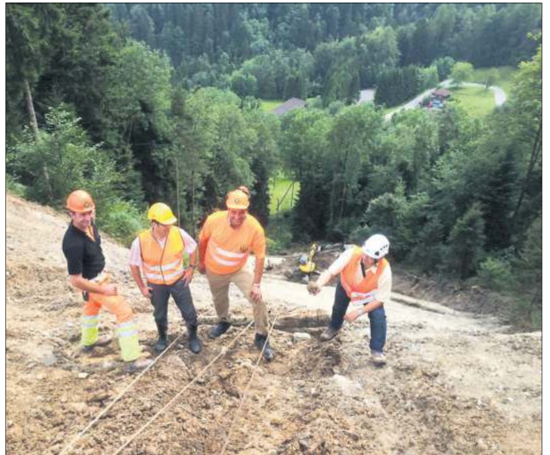
Nach den heftigen Regenfällen vom Juli laufen die Aufräumarbeiten im Krienser Hochwald zwischen der Hergiswaldbrücke und dem Forsthaus Stalden (rechts im Hintergrund) auf Hochtouren.
